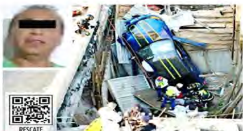
Rescate. La víctima cayó en una zona de excavación cerca de la Plaza Artz.
