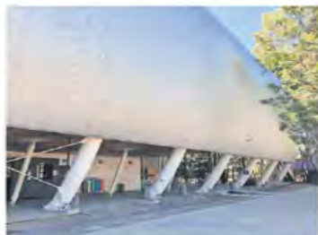
Las fachadas de las escuelas se encuentran en mal estado, debido a la falta de mantenimiento.
