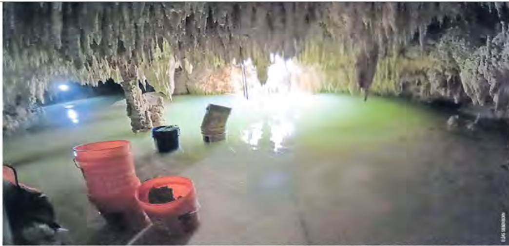
En el informe se detalla que al colocar los pilotes hubo afectaciones en las cavernas sobre las que corre el Tramo 5 Sur, como la caída de cemento en el agua.
