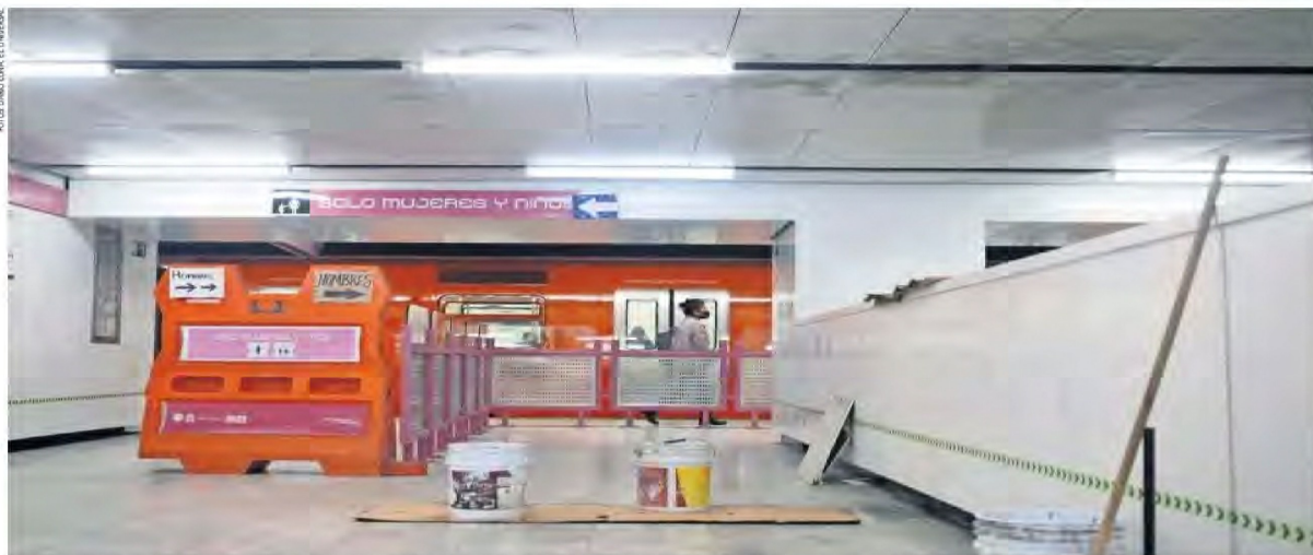
Las filtraciones se presentan en estaciones como Sevilla, Merced y Salto del Agua; el problema se origina en las jardineras del exterior, dijo el STC.
